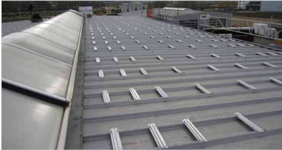
Avenches - Schweiz Anlage: 50 kW | MiniRail System
