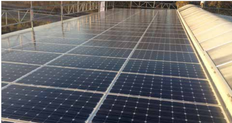
Avenches - Schweiz Anlage: 50 kW | MiniRail System
