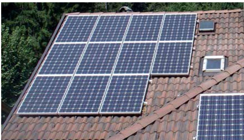
Elpo | Ehrenburg - Italien Anlage: 5,04 kW | Dachhaken System
